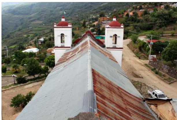
Cumbra y faldones de la cubierta con lámina galvanizada en mal estado.
