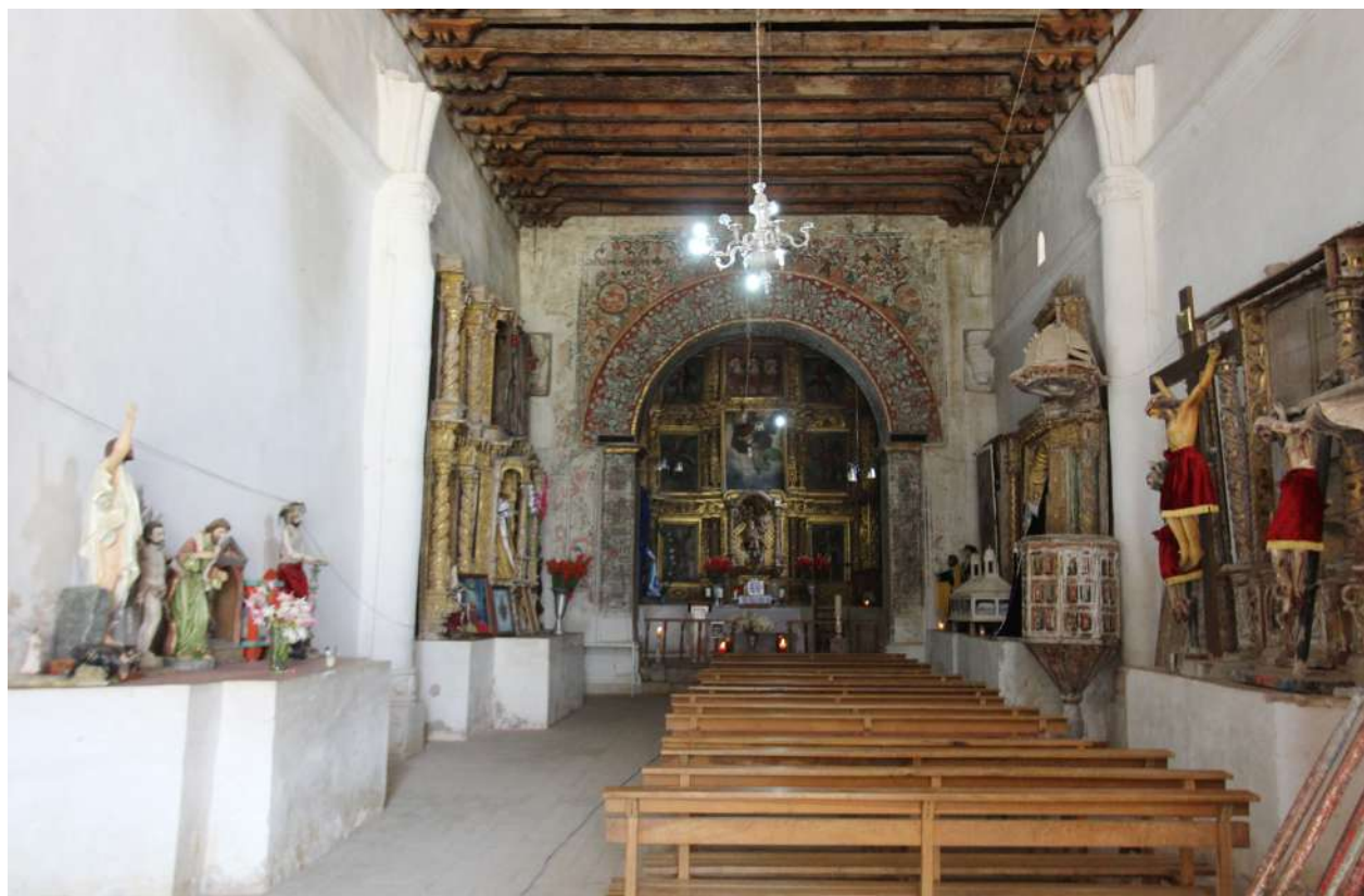
Vista general de la nave, en la parte superior se aprecian las vigas, la mayoría en mal estado de conservación.
