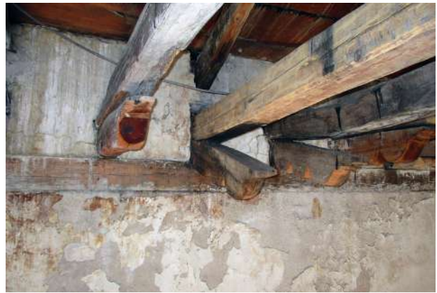
Zapatatas de madera en estado de pudrición.
