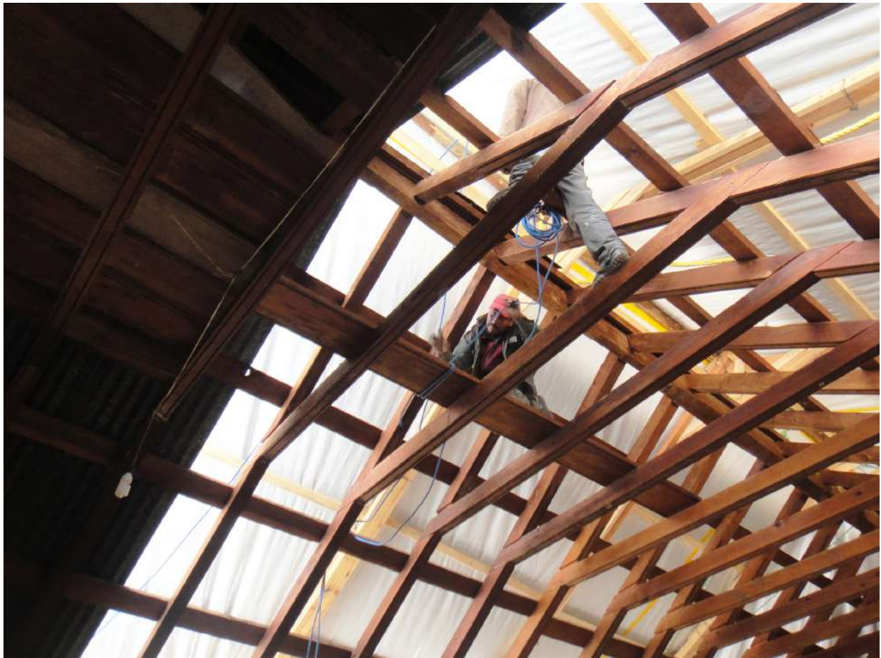
Las secciones de las vigas par y nudillos había sido reducidas como parte de alguna de las intervenciones de la que fue parte el templo.
