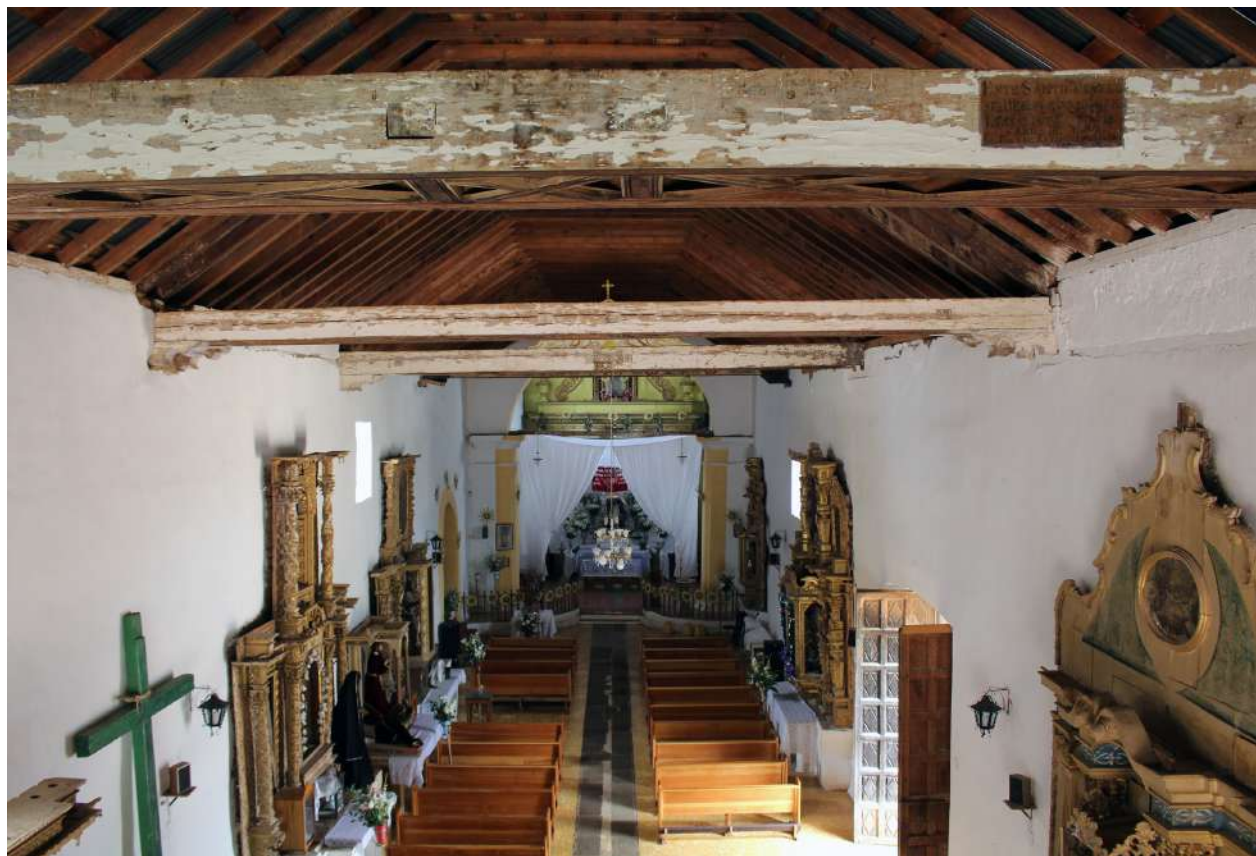
Vista tomada desde el coro, se puede apreciar estructura de la cubierta, en primer plano viga tirante fechada con el año de 1682.
