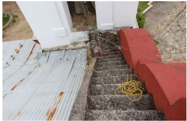
Vista parcial de cubierta, escalones sobre el muro correspondiente a la fachada principal.
