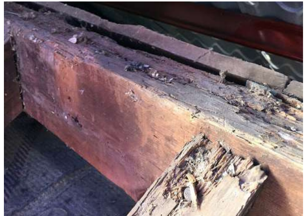
Deterioros por apropiación de insectos en viga cumbrera.
