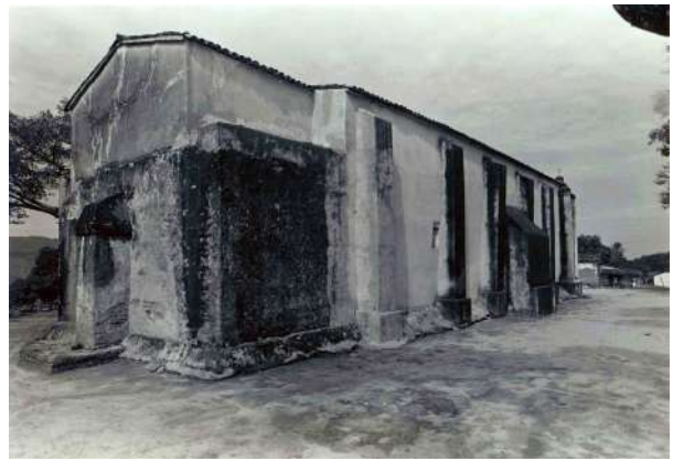
Templo de San Pedro Jicayán (Memoria descriptiva, maestra arquitecta María de Lourdes Aragón Luis).
