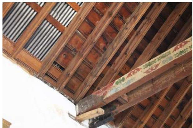
Vista de la cubierta, en donde se puede apreciar la viga tirante, vigas pares, entablado y lámina galvanizada.
