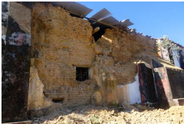
Colapso de muro de adobe de fachada lateral del templo.
