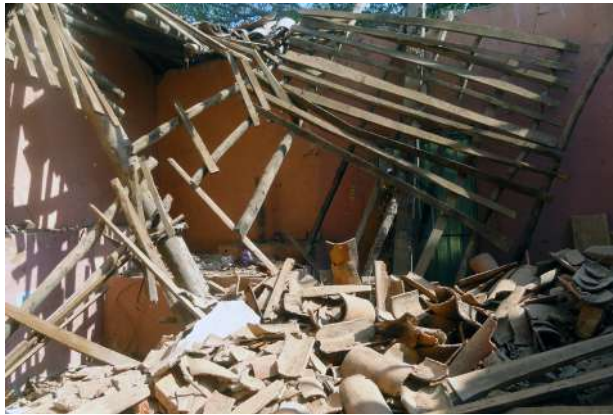
Colapso de cubierta de la sacristía.
