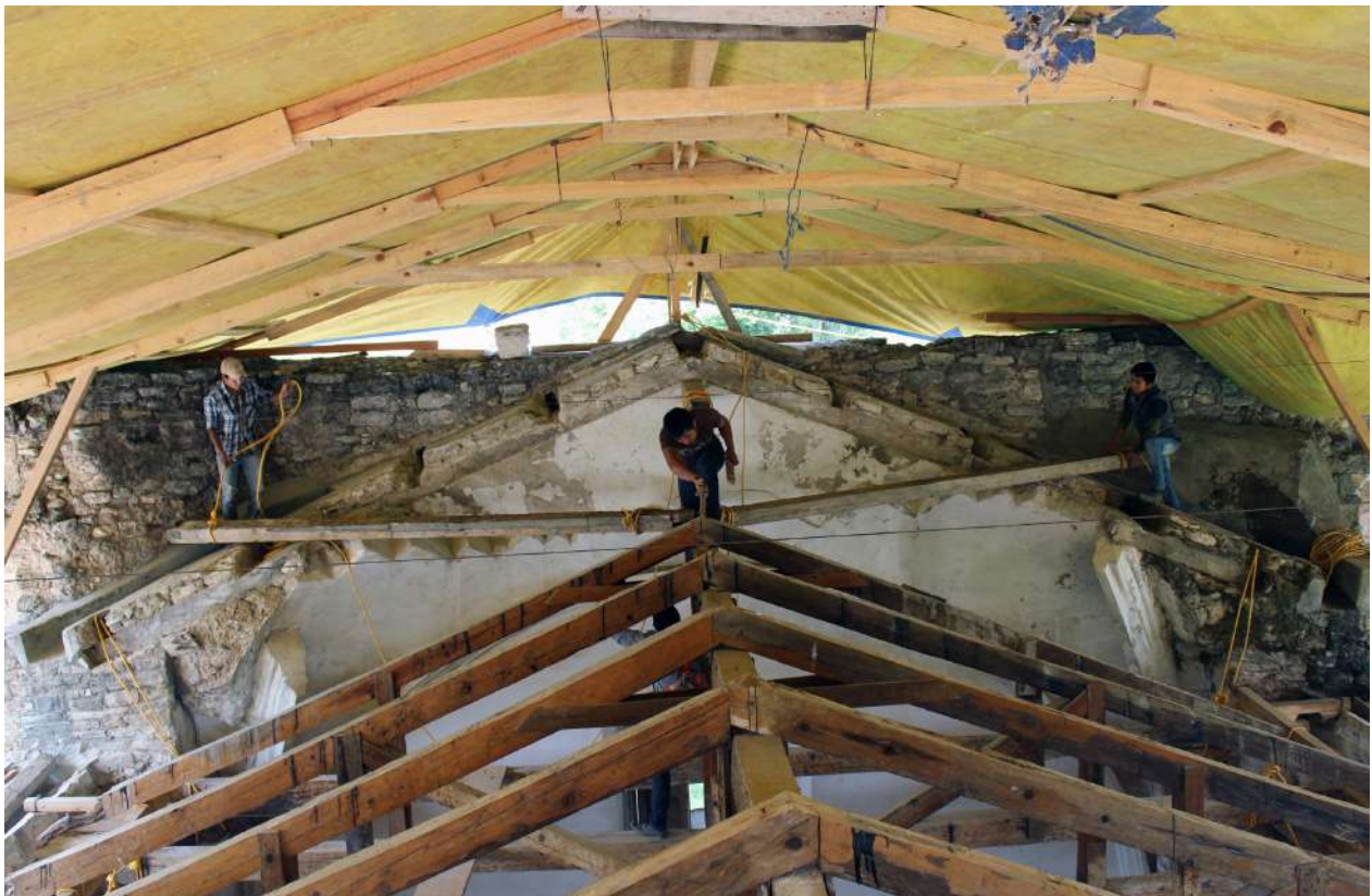
Cada una de las armaduras es integrada por vigas par, pendolón y zapatas.
