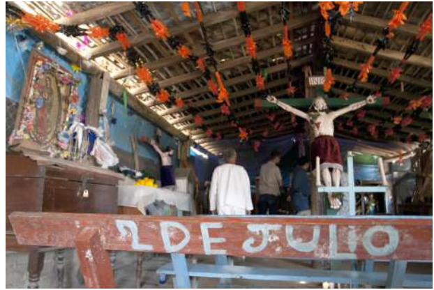
Lienzos y esculturas religiosas resguardadas en estructura provisional debido a los daños en el templo.
