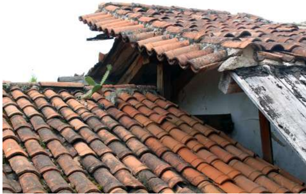
Detalles de teja de la cubierta, se aprecian acumulación de microorganismos y flora nociva.
