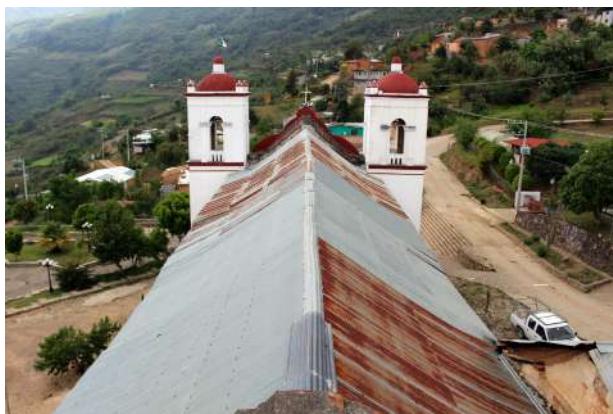
Cumbrera y faldones de la cubierta con lámina galvanizada en mal estado.
