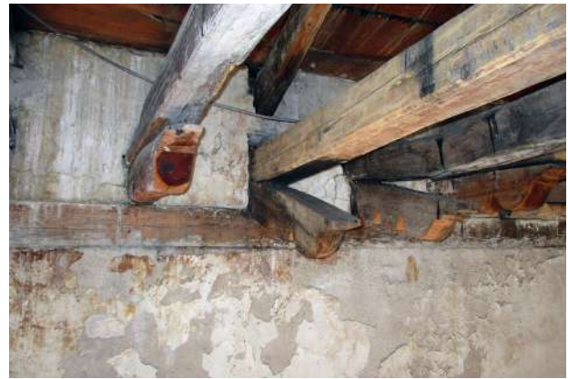
Zapatas de madera en estado de pudrición.
