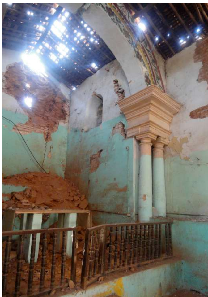
Colapso de muro testero y cubierta del presbiterio.
