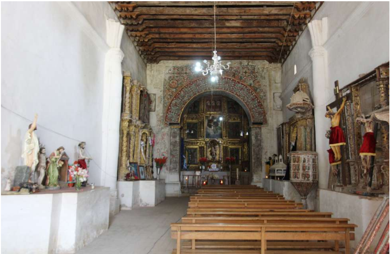
Vista general de la nave, en la parte superior se aprecian las vigas, la mayoría en mal estado de conservación.
